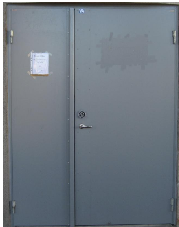
Exempel på dörr försedd med brytskydd och förstärkning runt cylinder
