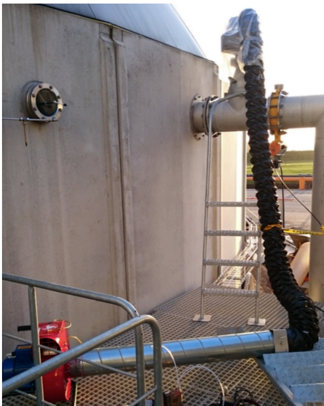
Figur 22. Utspädningsprovtagning av läckande säkerhetsventil.
