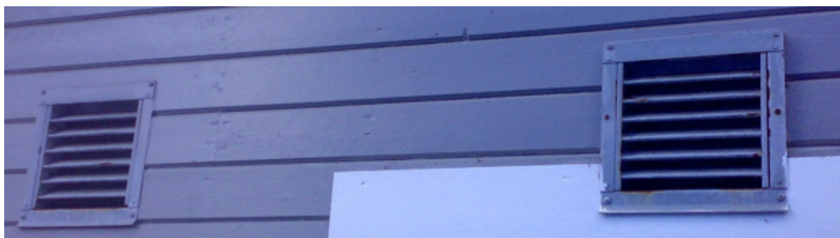
Figur 13. Ventilationsöppningar i gasutrustningshus.
