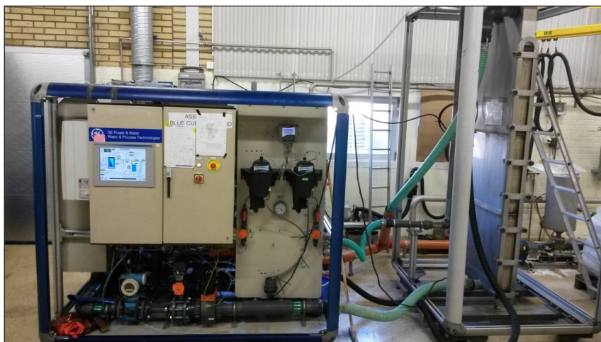
Figur 2.3 Ultrafiltreringsanläggningen i pilotskala på Kalmar ARV. Membrankassetter till höger och styrsystem, permeattank (mellanlagring av filtrerat vatten) och tvättkemikalier till vänster i bild.
