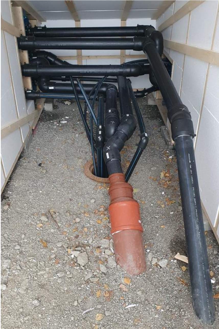
Figur 21, Anslutningar mellan containers
