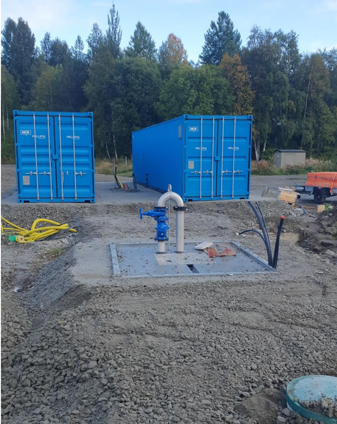
Figur 29, Övertäckt pumpstation och kanalisation med containersystem på plats
