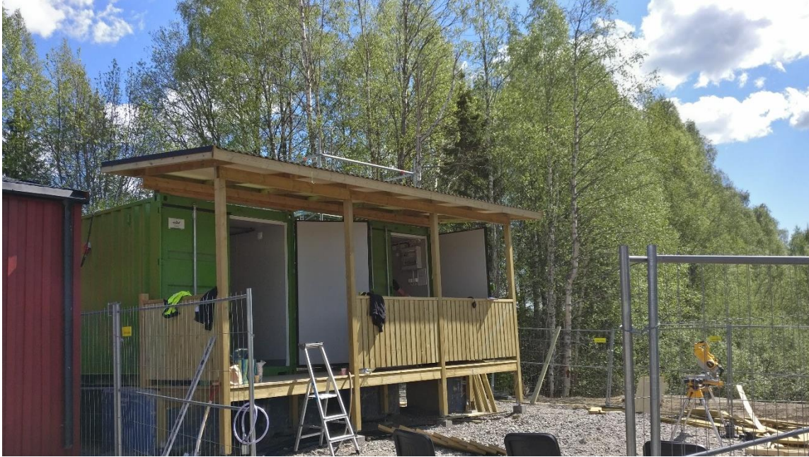
Figur 15. Levererat RENA Tellus system vid Flurkmarks avloppsreningsverk
