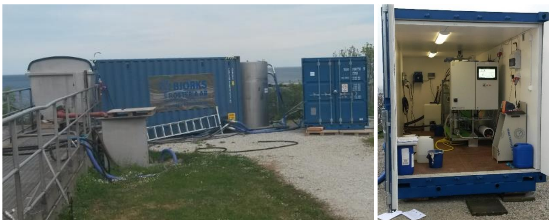
Figur 2. Pilotanläggningens uppställning, från vänster Trumfilter, UF-filter, bufferttank efter UF-filter, RO-filter.
