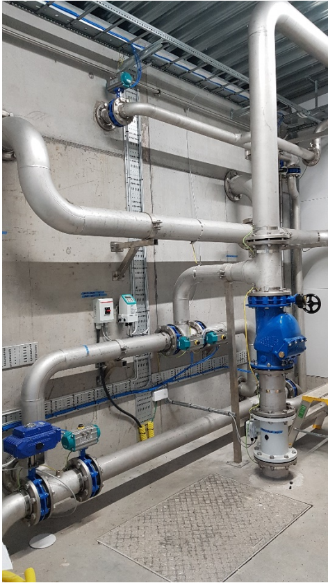
Invändigt utrymme mellan kolfilter och befintlig byggnad. Ventilpaket för backspolning.
