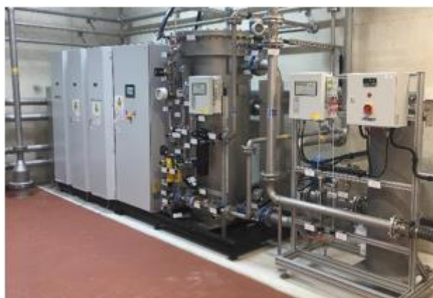
Figur 48. Ozongeneratoren och ozondestruktionsanläggning vid Aachen-Soers ARV i Tyskland.
